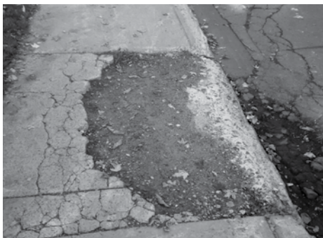
Trottoir endommagé le long de l'école St-André-Àpître (Photo : P. Rachiele)
