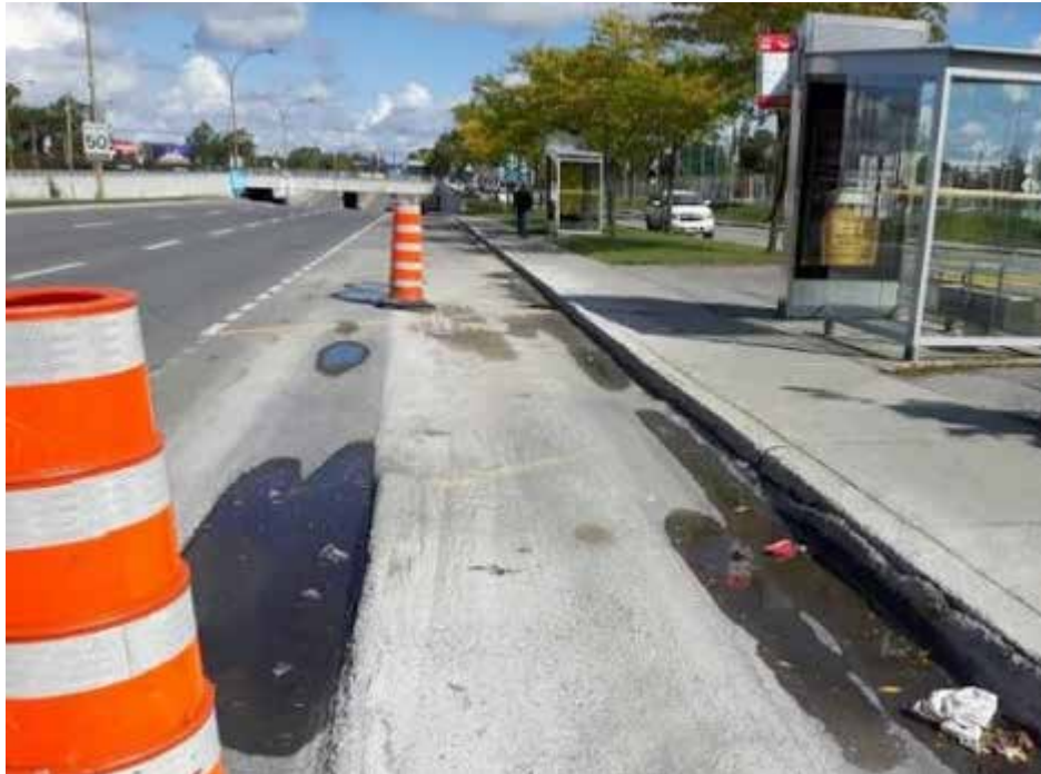
L'asphalte à l'arrêt d'autobus du Collège Bois-de-boulogne sur le boulevard Henri-Bourassa direction est est encore à refaire cette année. (Photo : jdv-Philippe Rachiele)
