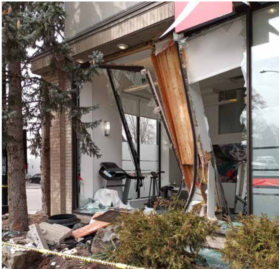
La façade endommagée de la clinique (Photo: Courtoisie, Antoine Bécotte)
