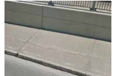
État du trottoir en 2014 (Source : Google Maps).png
