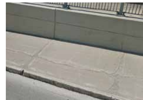
État du trottoir en 2014 (Source : Google Maps).png
