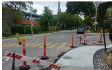
En 2019, la Ville de Montréal avait omis de construire une saillie de trottoir au coin des rues Prieur et Meunier lors de la reconstruction du trottoir. (Photo : Archives JDV)
