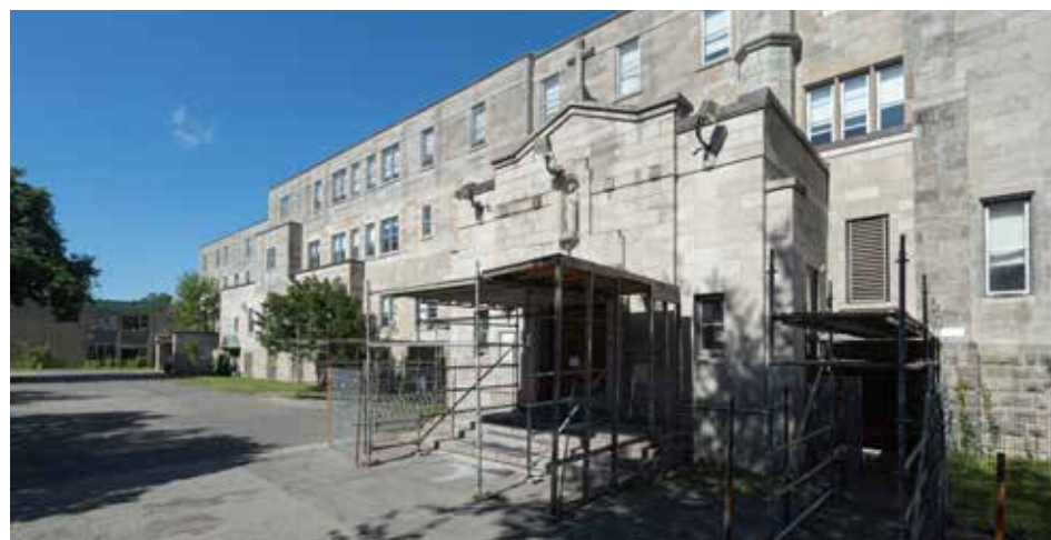
Une des ailes de l'école Sophie-Barat menace de s'effondrer. Les travaux, pour lesquels un budget de près de 170 M$ a été alloué, pourraient s'étendre sur 10 ans. (Photo : François Robert-Durand, JDV)
