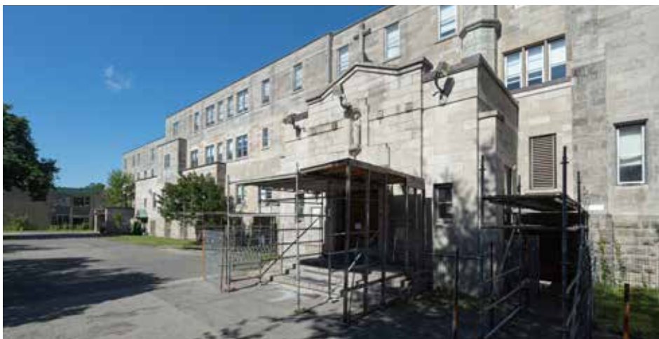
Une des ailes de l'école Sophie-Barat menace de s'effondrer. Les travaux, pour lesquels un budget de près de 170 M$ a été alloué, pourraient s'étendre sur 10 ans. (Photo : François Robert-Durand, JDV)
